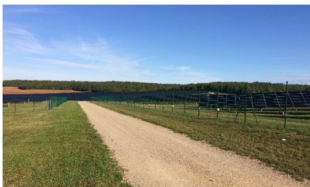
Figure 9 : Chemin d'accès sur la centrale solaire de Massangis (89), située sur un bassin d'alimentation de captage d'eau
