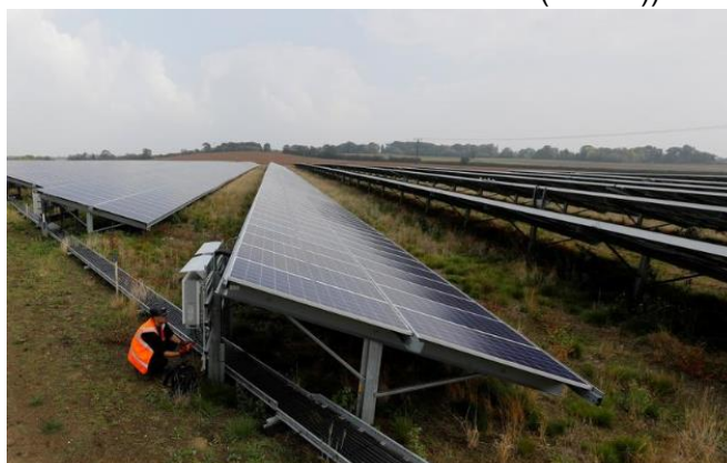
Figure 11 : Chemin de câbles (hors sol)
